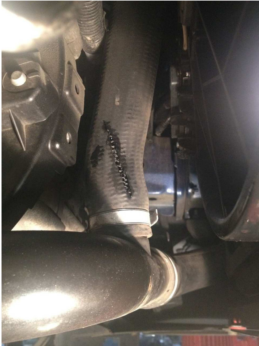
Bild 1 Obwohl der Riss im Ladedruckschlauch zu sehen war, hörte man kein verräterisches Zischen bei der freien Beschleunigung im Stand.
