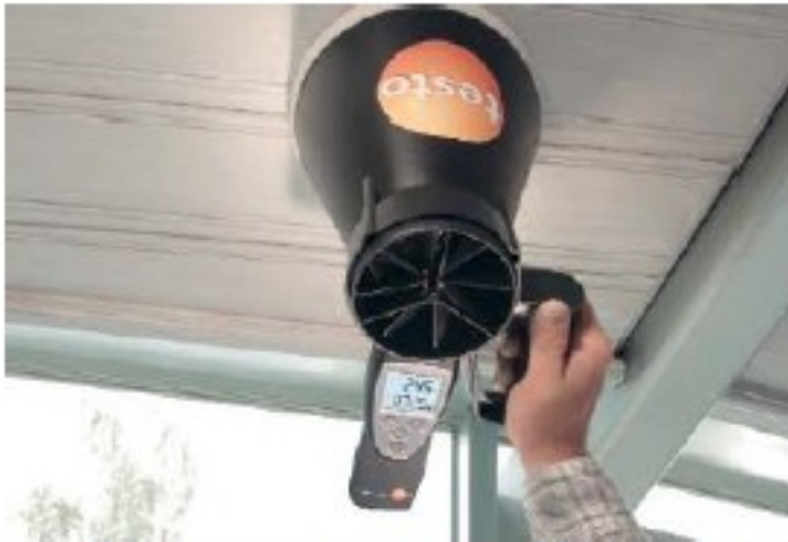
Kontrolle der Zuluft am Tellerventil
